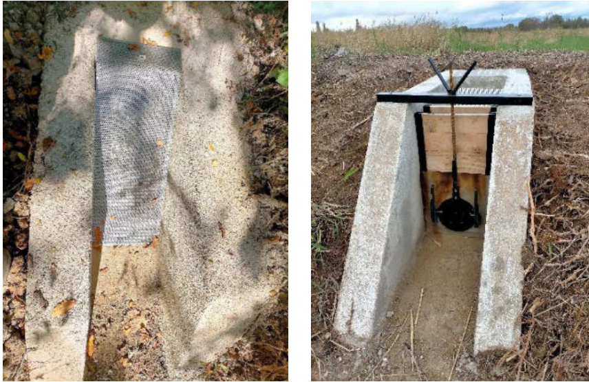
Figure 16 : Ouvrages de filtration installés sur le petit étang Cistude
